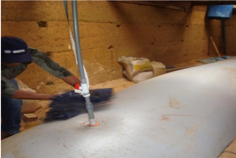
GEOMEMBRANA CON METANO
